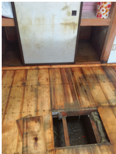
室内の被害状況も撮っておく
