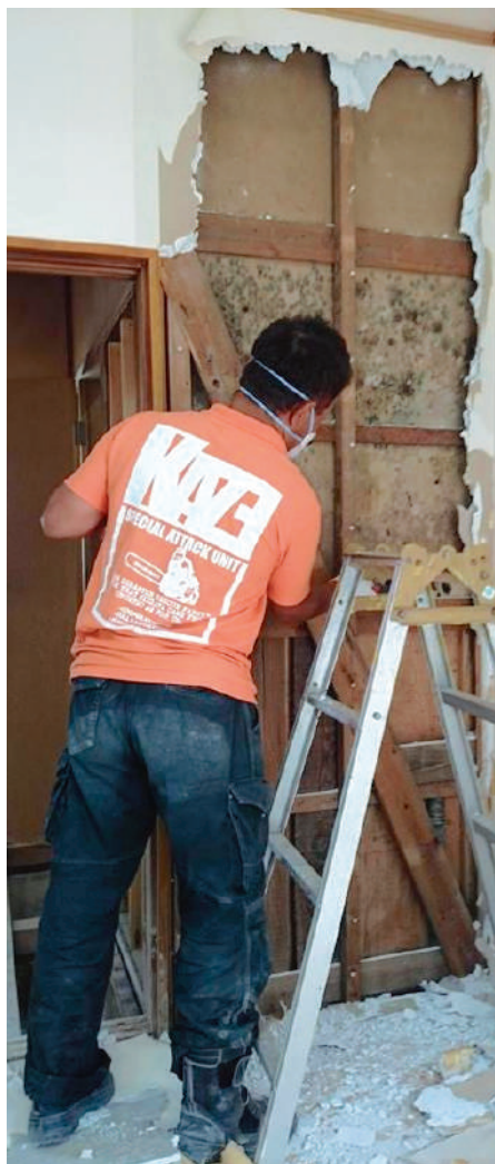
壁をはがすとカビが生えている
