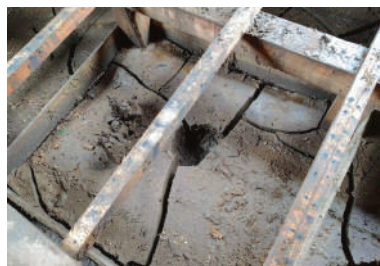
床下にたまった泥（写真③）
