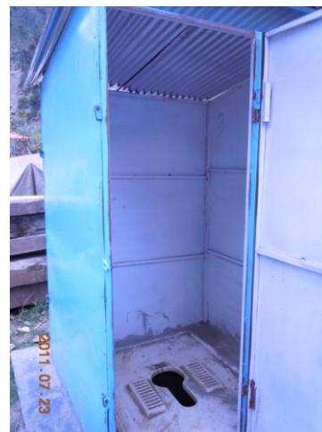
図 1-1-3 バザール・ラノリア小学校に設置されたトイレ
