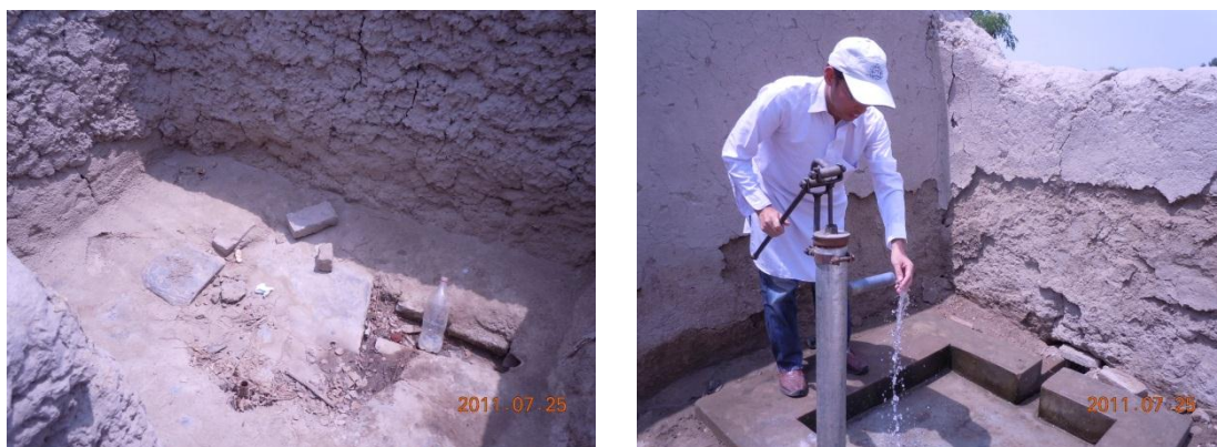
図 2-2-1 洪水によって被害を受けた井戸（左）と新設された井戸（右）
