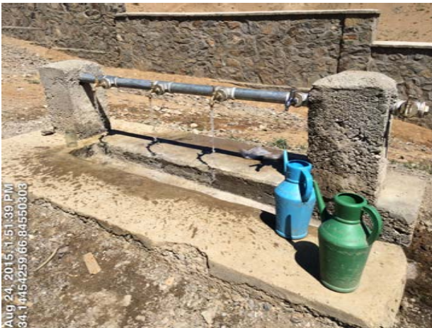
同校の給水施設
