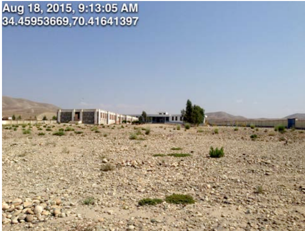
SVAによるナンガルハール州バララバッド校 洪水の影響で壁の一部が崩壊していた。
