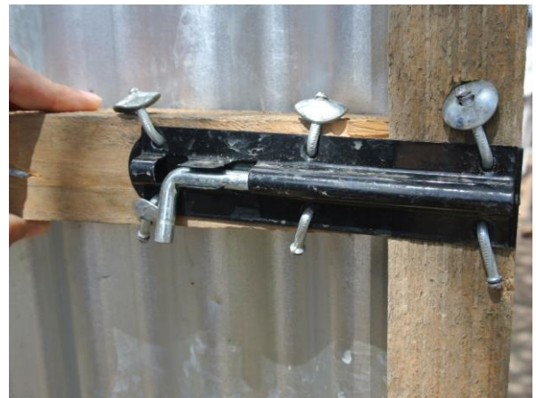
写真 4：建設中のトイレのドアに付けられた鍵。
