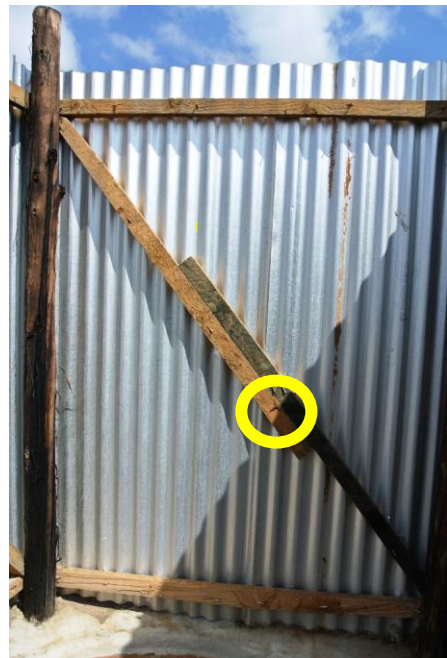
写真 6：円内部分の釘が若干浮いており、手や衣服が引っかかって怪我をしてしまう恐れがある。
