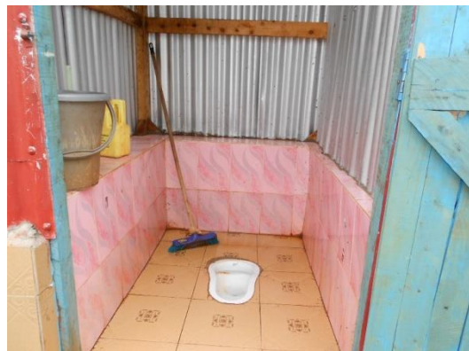
1ブースを9世帯で共有。世帯管理が行き届き、清掃状況も良好（IDP 再定住地区内）。
