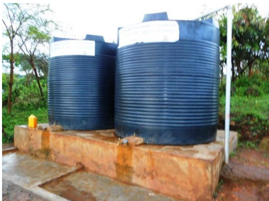
事業で設置されたタンク（診療所用）。
