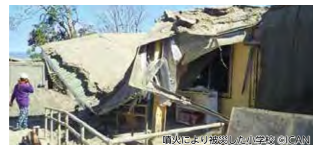
噴火により被災した小学校 ©ICAN
